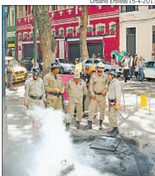
FUMAÇA EM bueiro da Rua Gomes Freire: perigo
